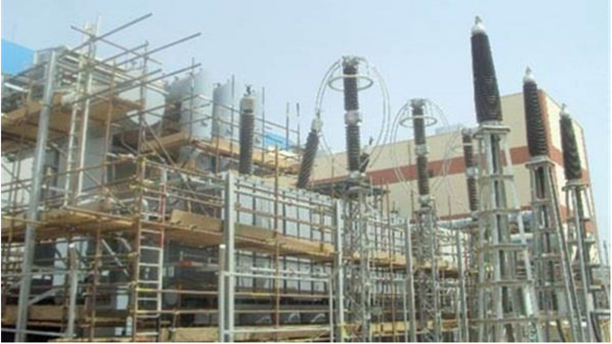
محطة كهرباء بنها
