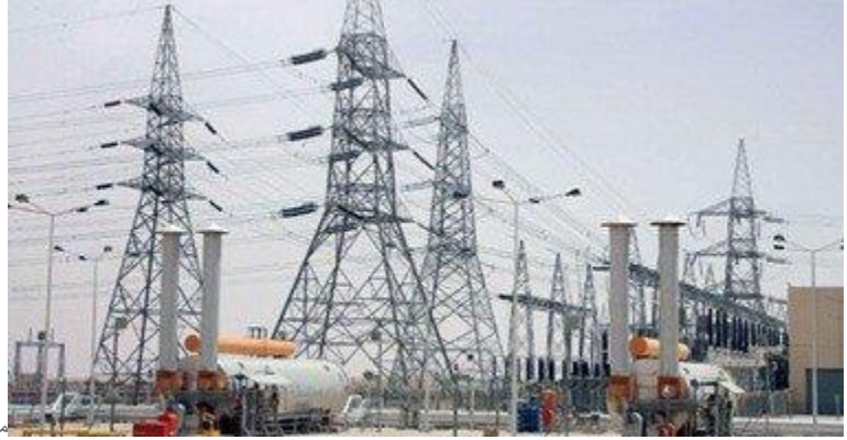
محطة كهرباء - أرسيفية
